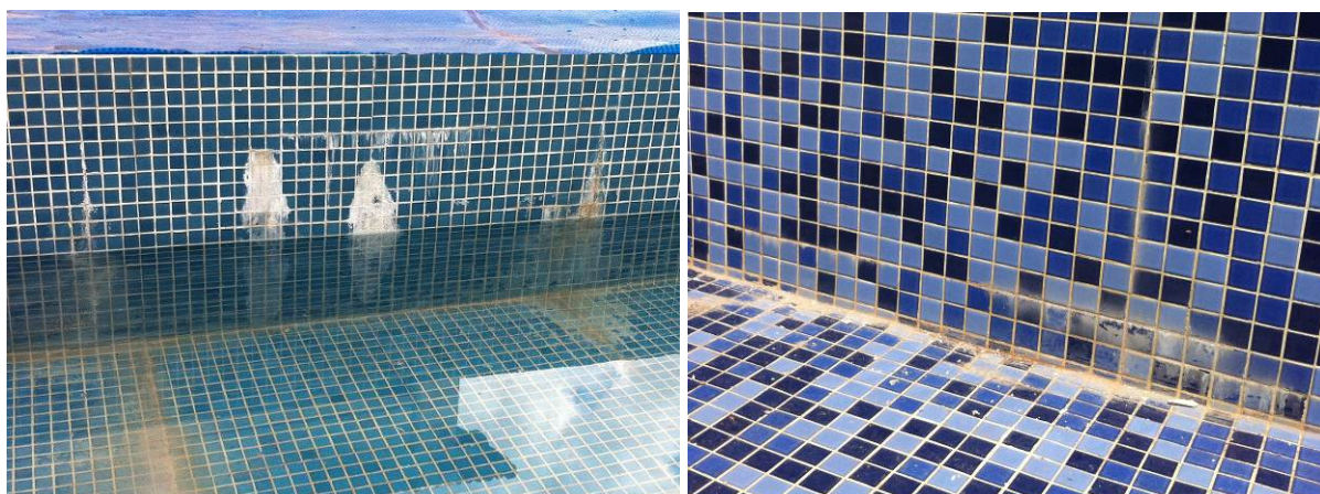
Figura 1: Eflorescência em piscina
