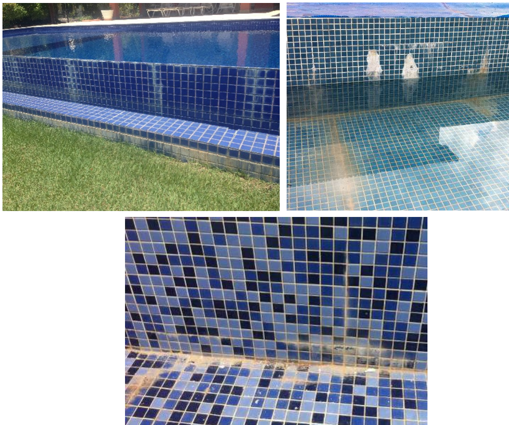
Figura 5: Eflorescência em piscinas
