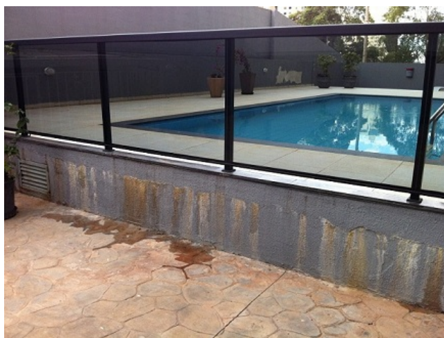
Figura 2: Eflorescência em deck de piscina
