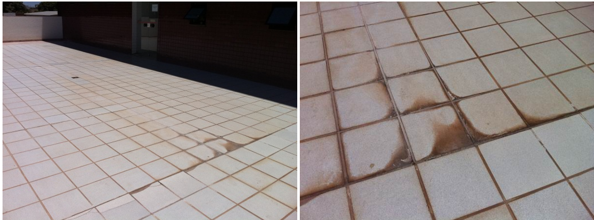
Figura 4: Eflorescência no piso
