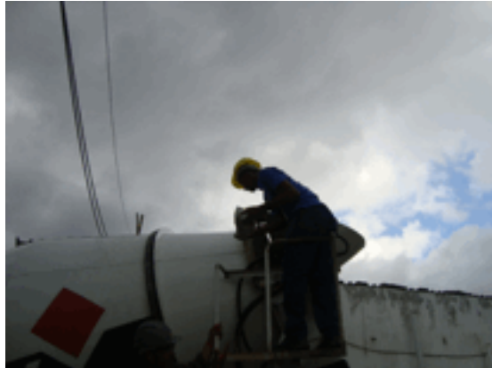
Foto 2 – Aditivo redutor de permeabilidade por cristalização em saco hidro solúvel sendo adicionado no balão do caminhão.
