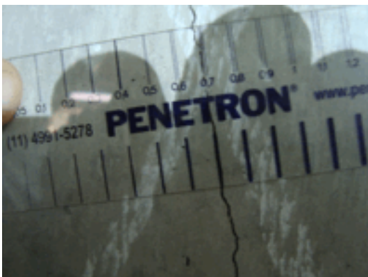
Foto 8 – Fissura passiva com abertura > 0,4mm.
