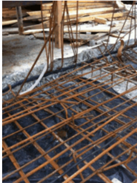
Foto 4 – Junta de concretagem da laje de subpressão com o veda juntas hidroexpansivo instalado.
