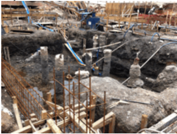
Foto 13 – Estacas raízes concretadas e expostas.
