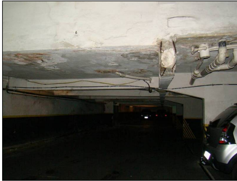
Foto 2 – Patologias de infiltrações com efeitos nas estruturas e revestimentos de edifício; observações realizadas durante perícia de engenharia judicial, em 2012 [12].
