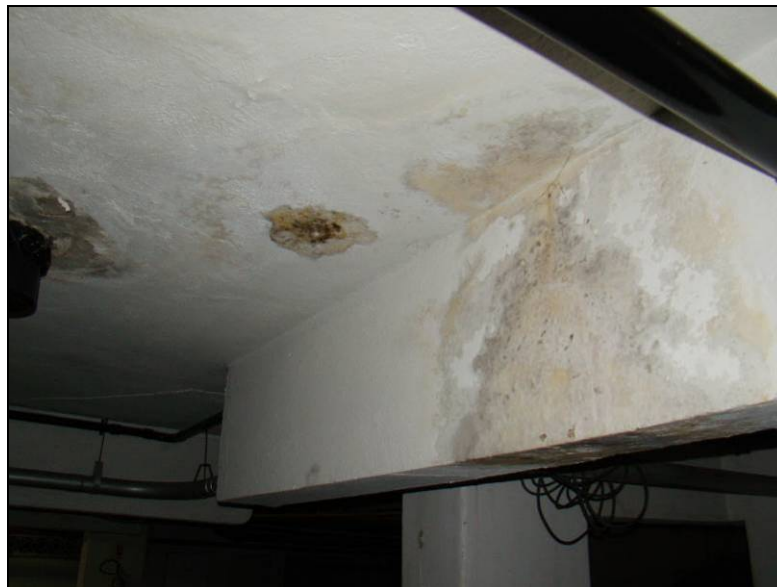
Foto 4 – Patologias de infiltrações com efeitos nas estruturas e revestimentos de edifício; observações realizadas durante perícia de engenharia judicial, em 2011 [13].
