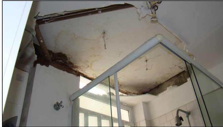
Foto 5 – Patologias de infiltrações entre apartamentos de edifício; observações realizadas durante perícia de engenharia extrajudicial, em 2012 [17].
