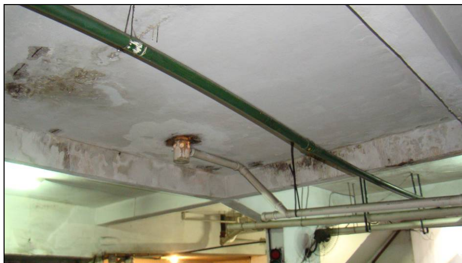
Foto 3 – Patologias de infiltrações com efeitos nas estruturas e revestimentos de edifício; observações realizadas durante perícia de engenharia judicial, em 2012 [12].
