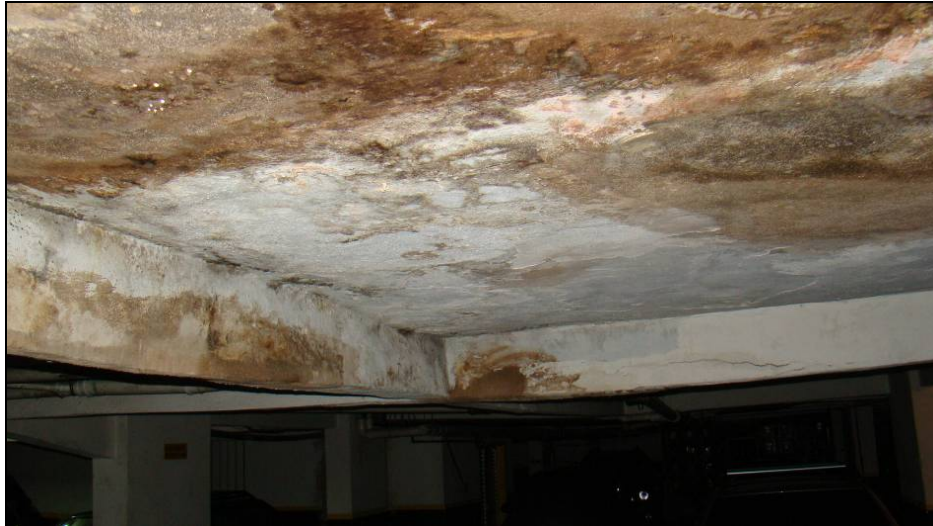
Foto 1 – Patologias de infiltrações com efeitos nas estruturas e revestimentos de edifício; observações realizadas durante perícia de engenharia judicial, em 2012 [12].
