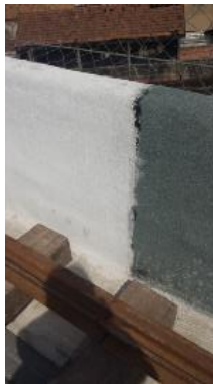
FOTO 05 – Pintura de Cal sobre manta asfáltica ardosiada
