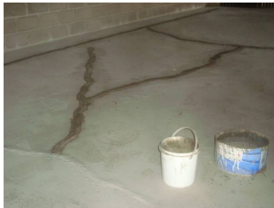
Figura 16 - Fissura preenchida com graute.
