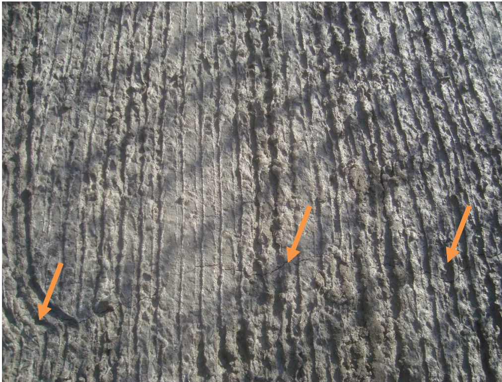
Figura 12 - Exemplo de fissura que surgiu em toda a extensão a laje
