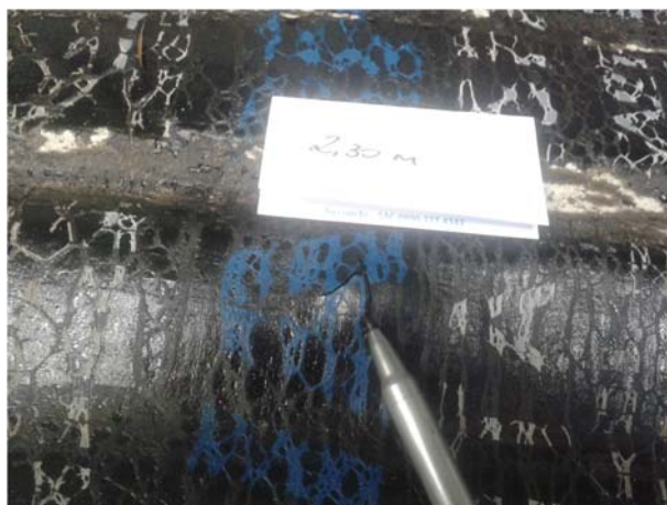
Foto 9: Mantas asfáltica danificada após ensaio de impacto
