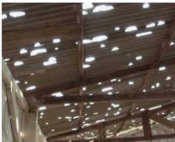
Foto 2: Telhado de fibrocimento sem manta asfáltica danificado após chuva de granizo
