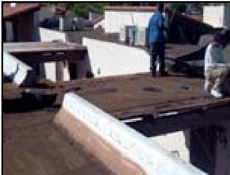
Foto 7 – Impermeabilizações asfálticas em diversas deterioradas e apresentando infiltrações, em 2006.
