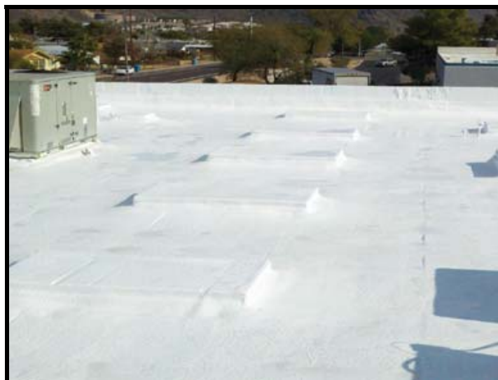
Foto 6 – Nova impermeabilização sobre a cobertura com sistema de membrana de silicone aplicada sobre isolamento térmico composto por placa rígida de poliuretano, apresentando desempenho até 2014.
