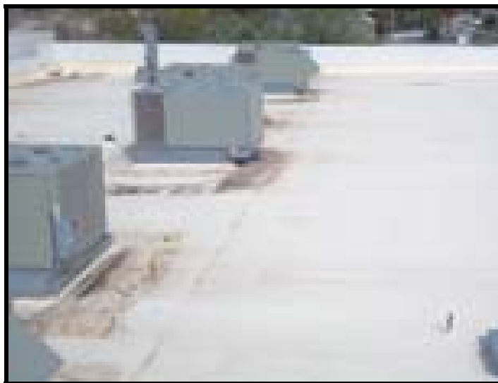
Foto 5 – Impermeabilização original deteriorada, em membrana de TPO sobre isolamento térmico.
