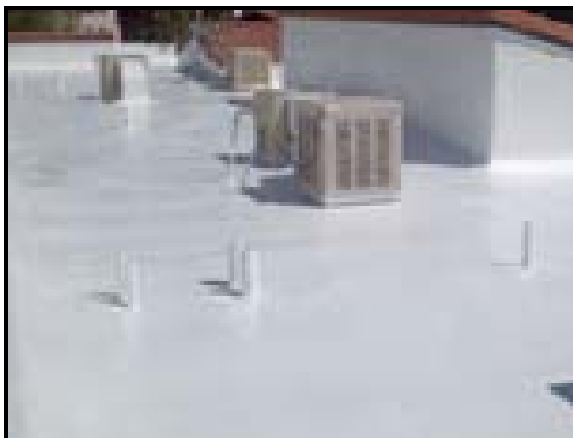
Foto 8 – Nova impermeabilização sobre a cobertura com membrana de silicone aplicada sobre isolamento térmico composto por placa rígida de poliuretano, apresentando desempenho até 2014.
