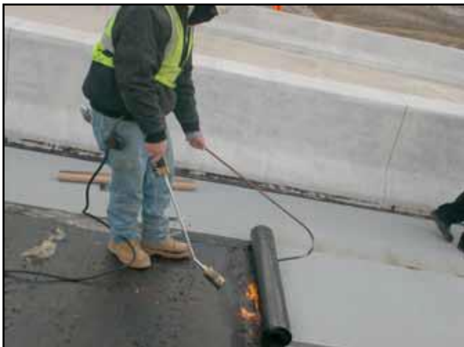
Foto 4 – Colagem de faixa da manta asfáltica pré-fabricada sobre a superfície imprimada com utilização de maçarico a gás (NCHRP Synthesis 425, 2012).
