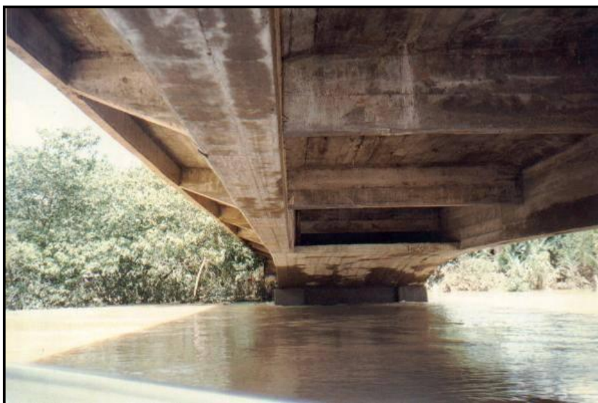
Foto 1 – Infiltrações e anomalias de lixiviação e eflorescências carbonáticas no concreto, com exposição das armaduras à corrosão.
