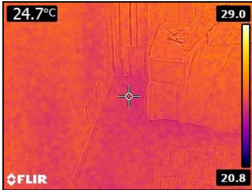
Foto 8 – Termografia indicando água confinada no revestimento de piso e parede do quarto adjacente ao banheiro do ap. 203, superior.
