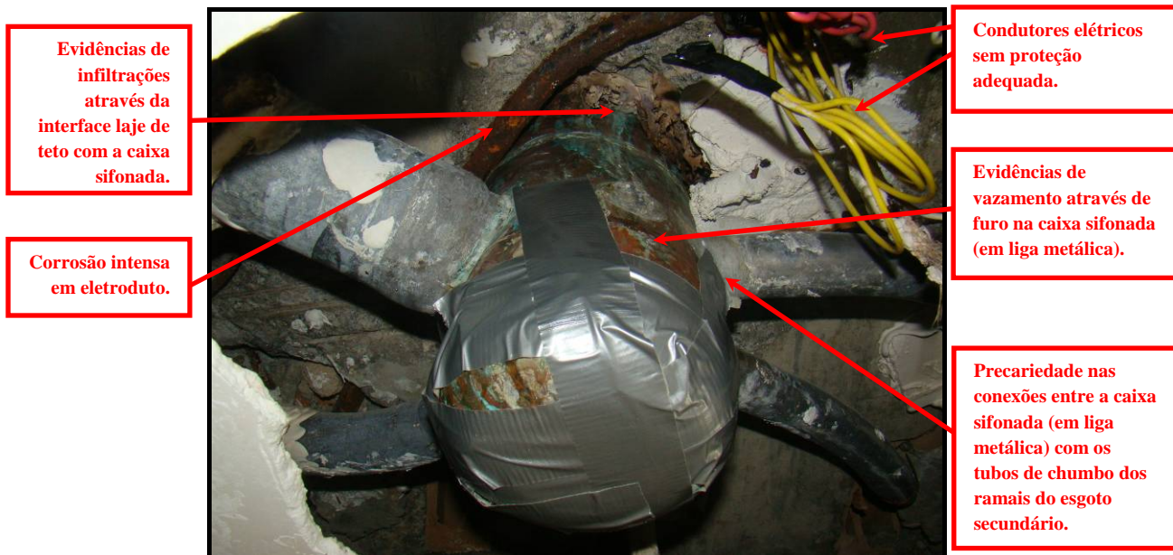
Foto 3 – Detalhe em maior aproximação visual, da área de teto de banheiro social do ap. 103 (da Autora). Evidências de infiltrações através da laje de suporte/apoio do banheiro social correspondente do ap. 203 (dos Réus) na interface com a caixa sifonada (em corpo formado por liga metálica), vazamentos na dita caixa sifonada e precariedade nas suas conexões com os tubos de chumbo dos ramais do esgoto secundário. Ademais, nota-se corrosão intensa em eletroduto e condutores elétricos sem proteção adequada em região de infiltrações e vazamentos.
