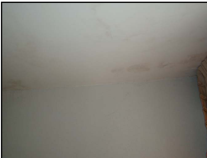
Foto 10 – A umidade confinada sob o revestimento de teto e parede do ap. 103 inferior pode ser mais bem percebida em observação visual do que na termografia da Foto 9 anterior.
