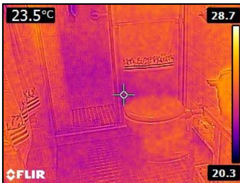
Foto 7 – Termografia indicando água confinada no revestimento de pisos e paredes do banheiro do ap. 203, superior.
